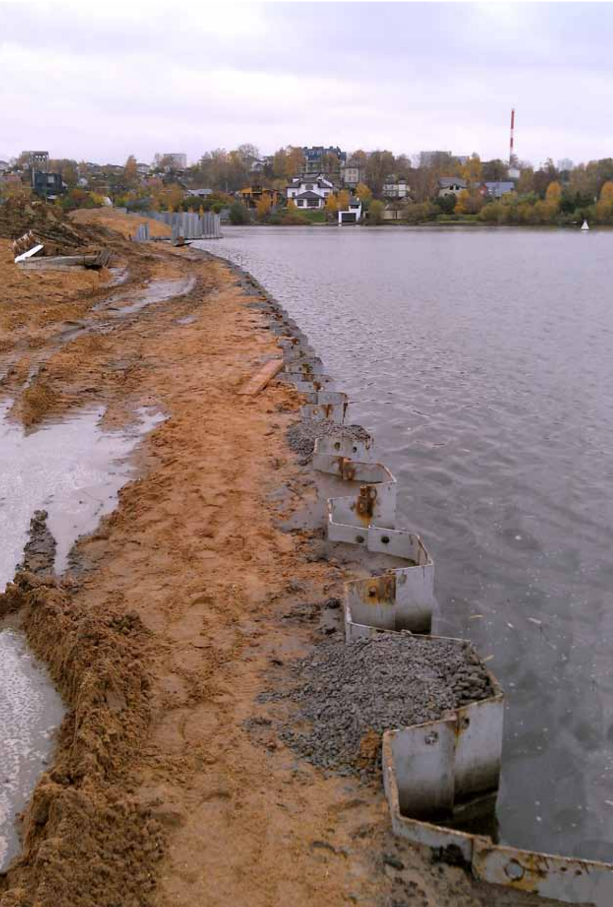
Берегоукрепление вертикального типа и строительство набережной Павшинской поймы. Московская область. Россия На странице справа Карлов мост. Прага. Чехия На следующем развороте EVRAZ VITKOVICE STEEL. Фотограф Karel Benes
